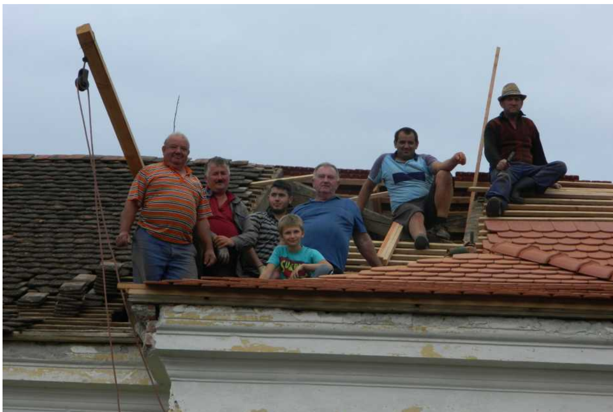
Anul 2019. Echipa de „maistori” din sat (Voivodeni), care a făcut reparații la Biserică, în timpul păstoririi preotului Iercoșan Ioan: Berindei Nicolae, Bucea Virgil, Bucea Gheorghe, Berindei Ovidiu, Oaneș Gheorghe.
