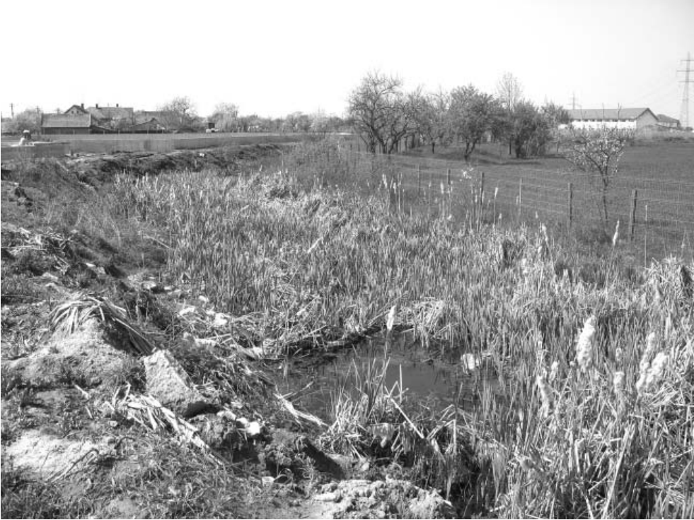
Colmatarea canalului Ier
